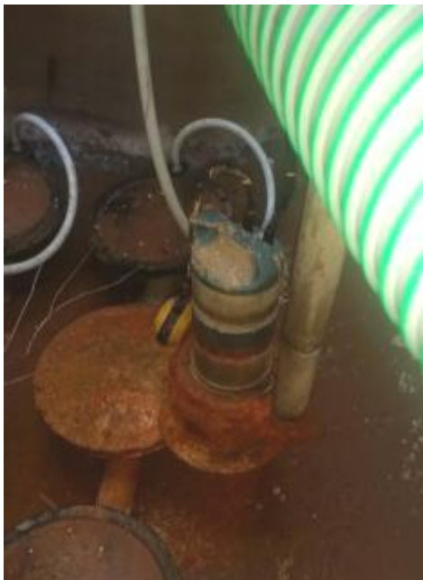
Slika 8: Pedrollo pumpa Vxm 8/35 u bioreaktoru
