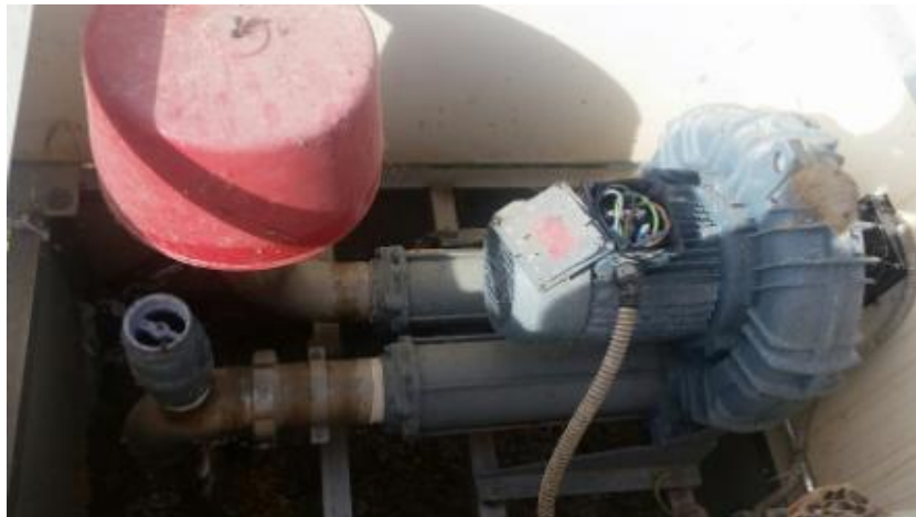
Slika 9: Postojeće stanje kompresora za vazduh
