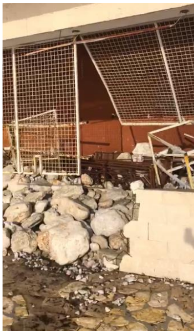
Slika 1.16. Šteta nastala na objektu na obuhvatu južne plaže tijekom nevremena
