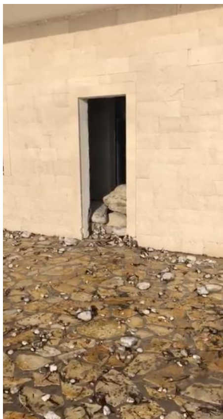
Slika 1.17. Uništeni sanitarni čvorovi
